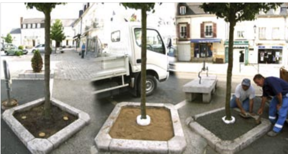
Une opération en 3 étapes : mise à nu du socle, pose d'un lit de sable, application de la préparation
