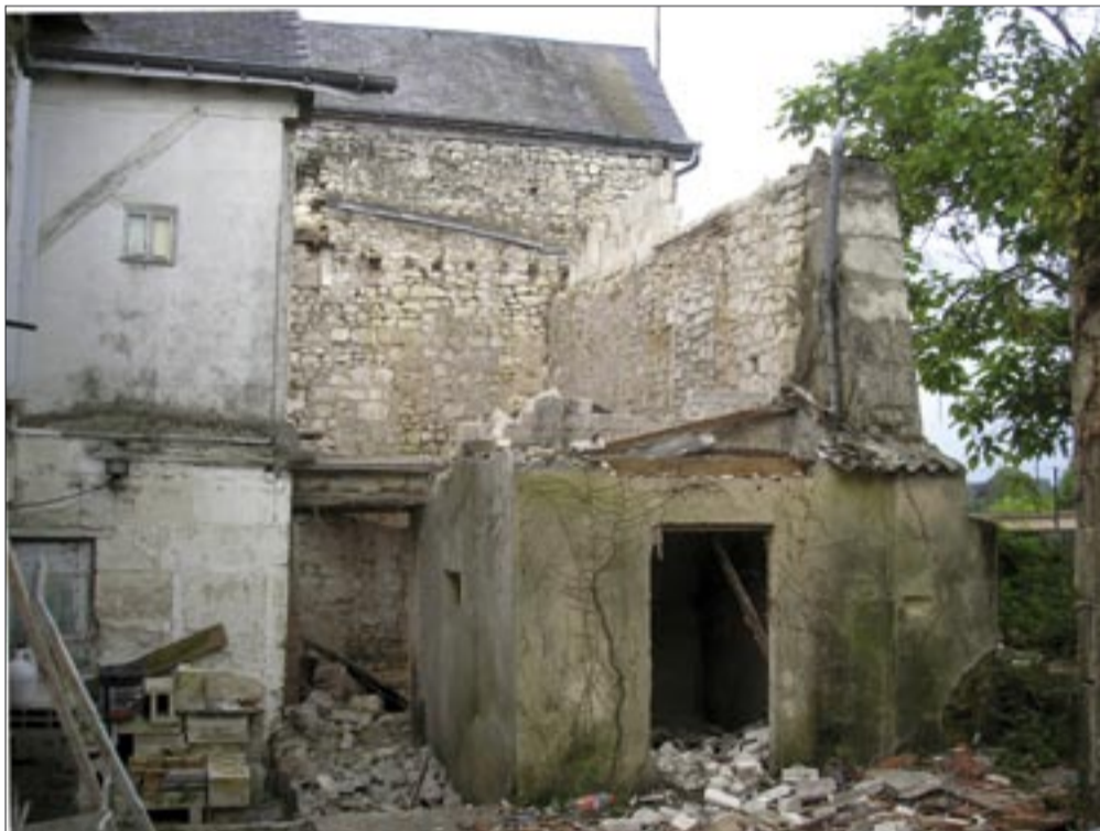
Avant d'abriter des logements, le bâtiment sis au n°59 a dû être partiellement démoli
