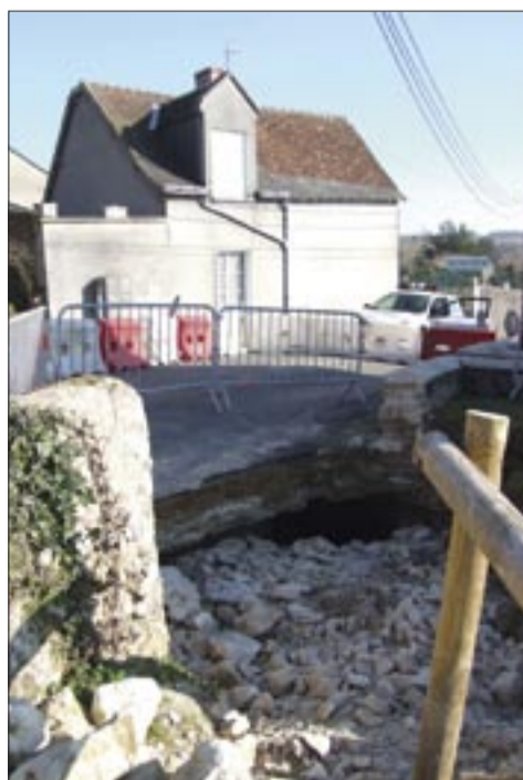
Une cave s'est effondrée
